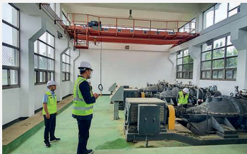
〈배수장 펌프 가동 점검〉
